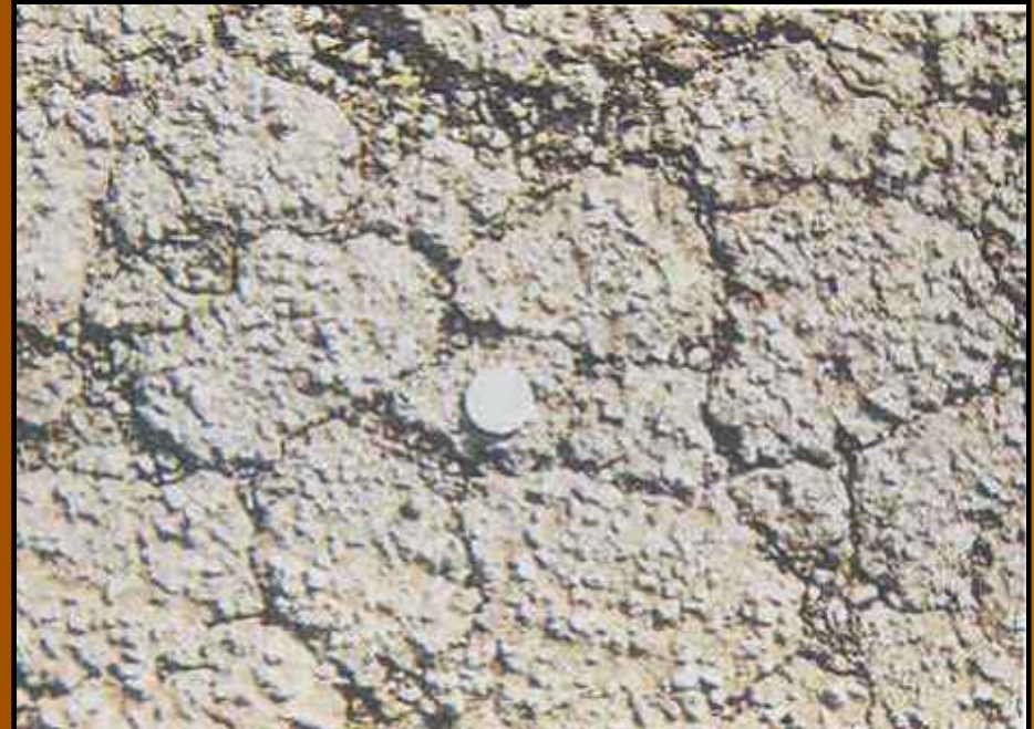
Revestimento oxidado com ocorrência intensa de trincas por fadiga com borda alargada.
