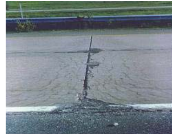
Tricas isoladas severas
