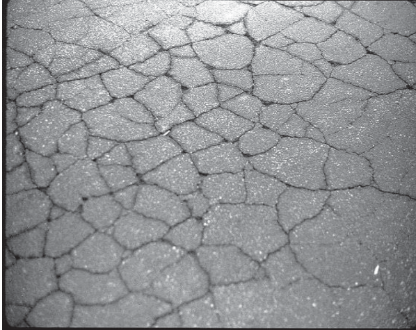
Trincas do tipo alligator cracking
